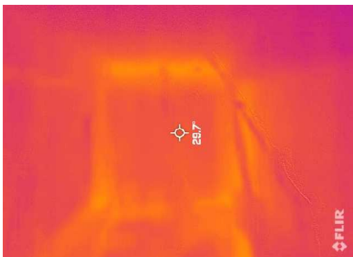
修復完了後の漏水試験結果異常無(赤外線カメラ画像)
